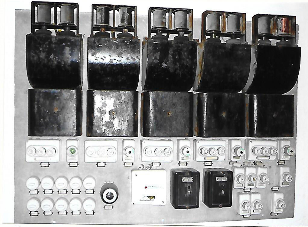
SCHALTZENTRALE FÜR GLOCKENGELÄUTE
